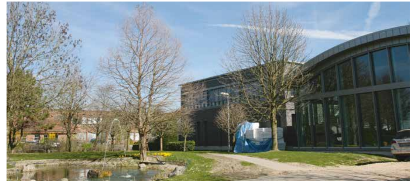
Die Arbeiten am Technology Center schreiten plangemäß voran. Im Frühherbst wird das Gebäude eingeweiht.
